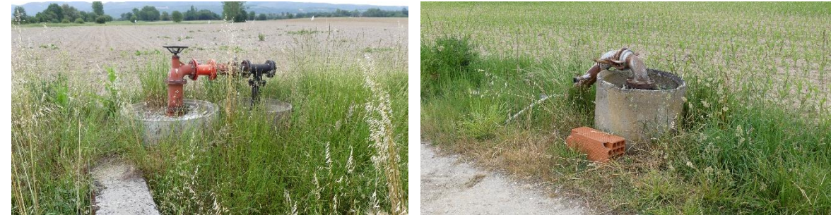
Bornes d'irrigation en bordure est de la zone d'étude pour l'activité agricole
