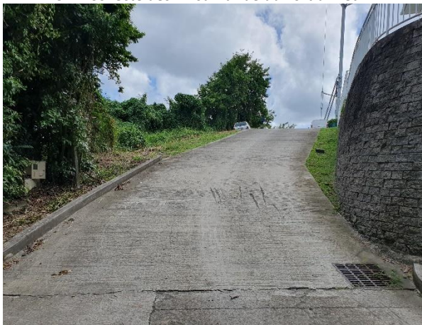
33 – Collecte des EP sous la résidence Tangarane
