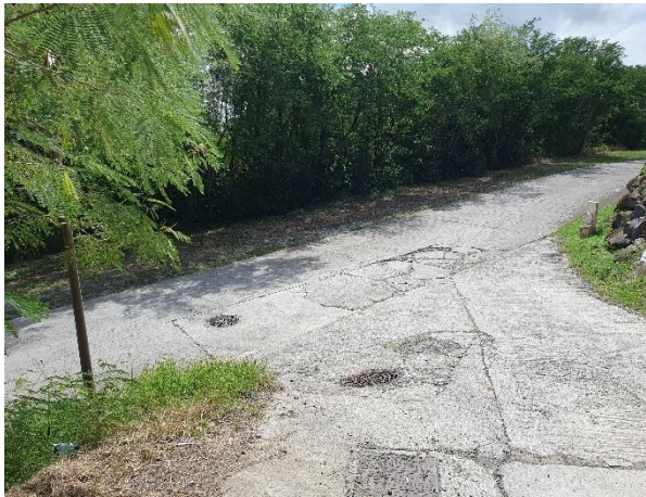
31 – Collecte des EP sur la rue du Fort d'Alet
