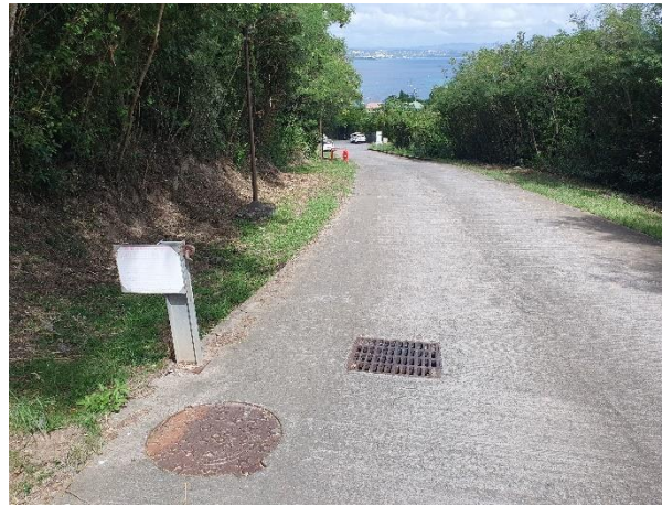
30 – Collecte des EP sur la rue du Fort d'Alet
