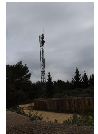
Antenne 5G Source : ARTIFEX 2023
