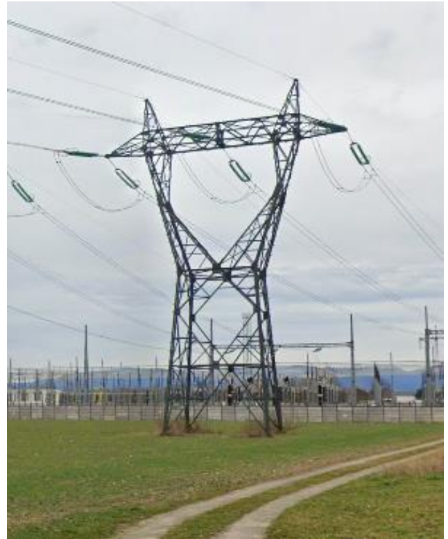
Exemple de pylône d'arrivée au poste électrique
