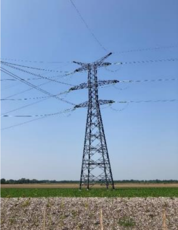
Exemple de pylône de raccordement sur les lignes aériennes existantes
