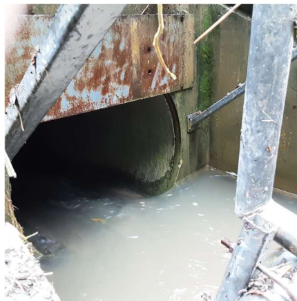
Figure 4 : Conduite DN 1200 permettant la régulation du débit dans le ruisseau de Tournes
