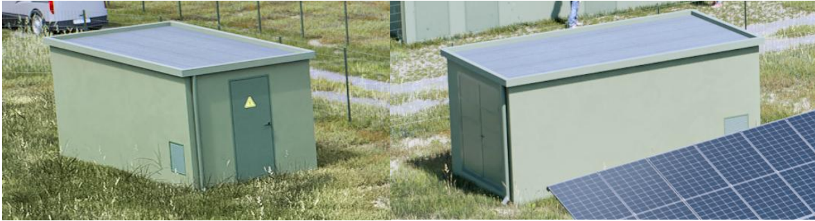
Figure 8 : Poste de transformation utilisé dans le cadre du projet de Saint-Aoustrille
