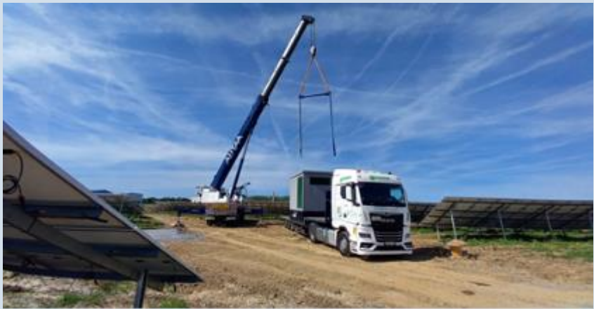
Photographie de l'installation d'un poste de transformation
