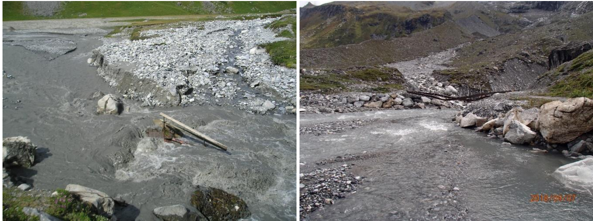
Figure 6 : passerelle au niveau du verrou emportée lors de la crue de 2015 (à gauche) – nouvelle passerelle fortement dégradée en 2018 (à droite)
