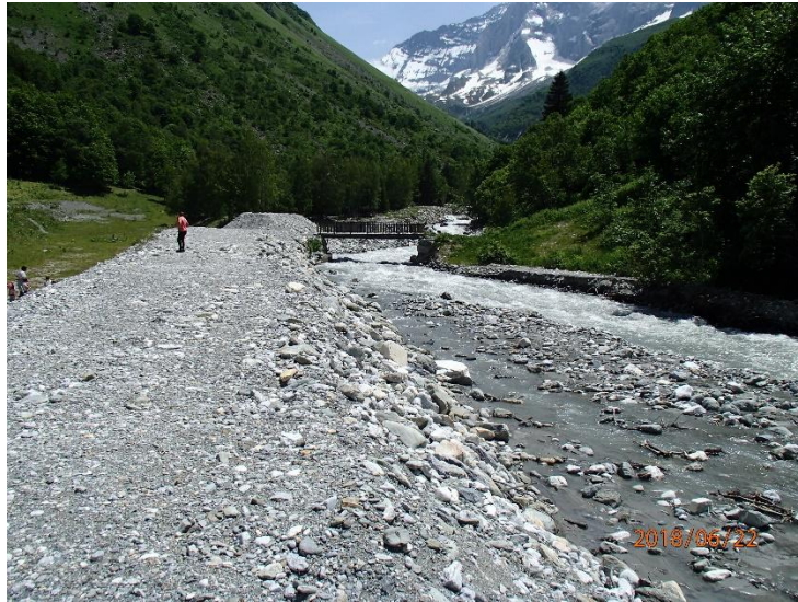
Figure 14 : Rupture de pente et passerelle piétonne
