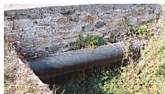
Ouvrage n°38 à Issoire – Buse arche très encombrée
