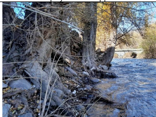
Erosion de la berge gauche
