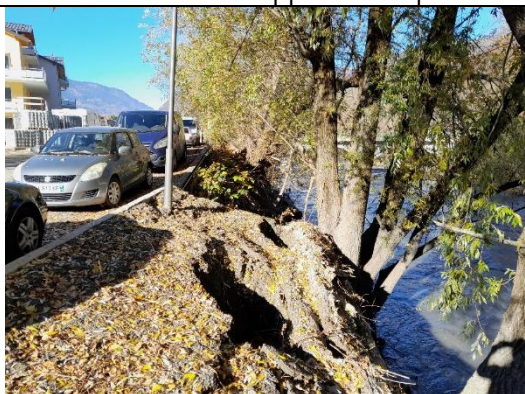
Erosion de la berge sous le parking
