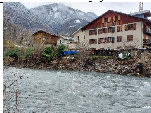
Erosions au niveau des terrains privés amont
