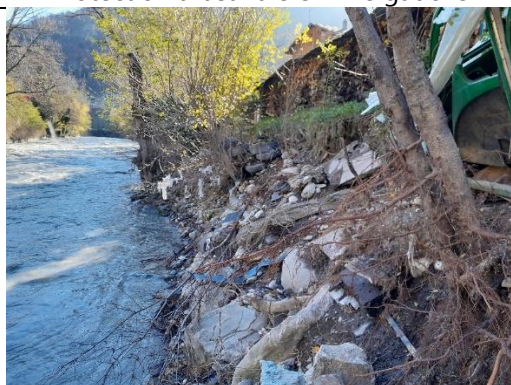
Déchets dans le corps de berge
