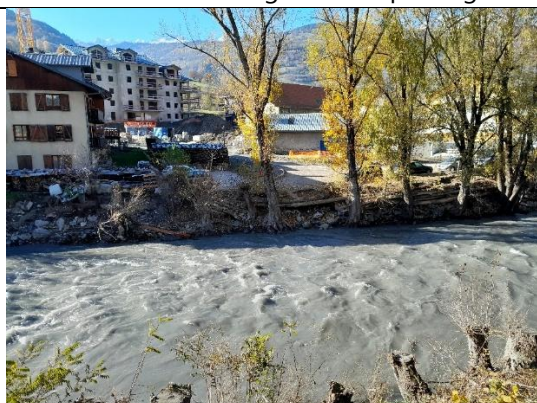
Protection artisanale en rive gauche
