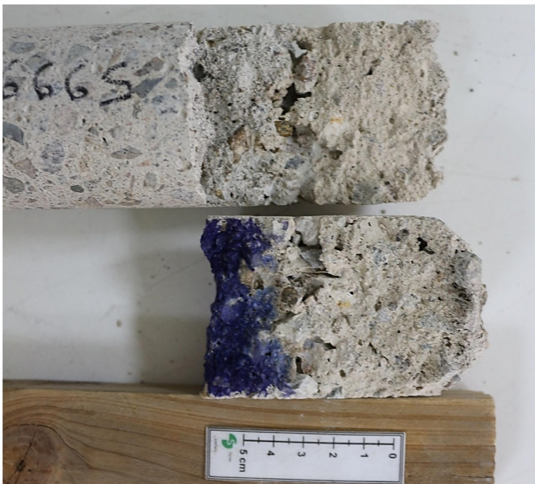
Illustration du front de carbonatation (surface testée à droite)
