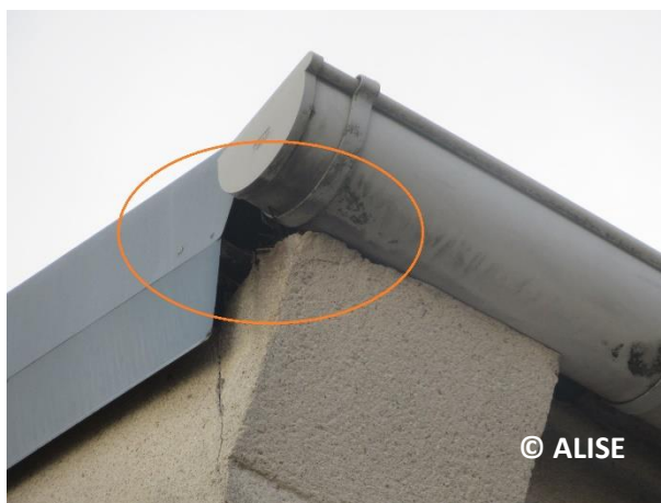
Photo 28 : Nid derrière la gouttière des bureaux (photo sur site)
