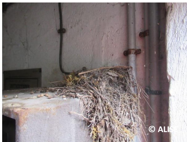
Photo 33 : Nid sur une armoire électrique (photo sur site)
