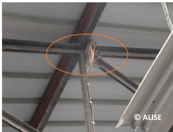
Photo 27 : Détail d'un des nids (photos sur site)
