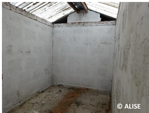
Photo 12 : Combles fermés de la partie laboratoire. Potentiellement favorable (photo sur site)
