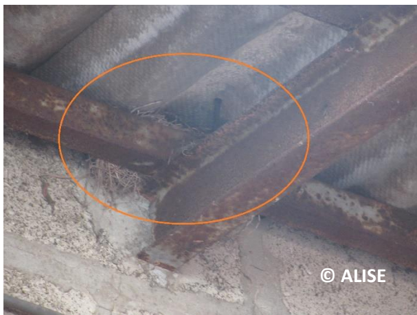
Photo 31 : Nid dans la charpente d'un garage ouvert (photo sur site)
