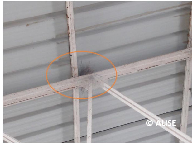
Photo 30 : Nid dans la charpente du court de tennis (photo sur site)
