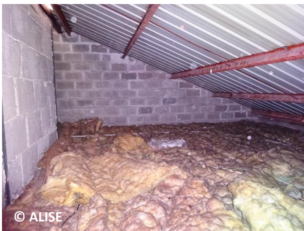
Photo 11 : Combles non favorables de la partie laboratoire (photo sur site)
