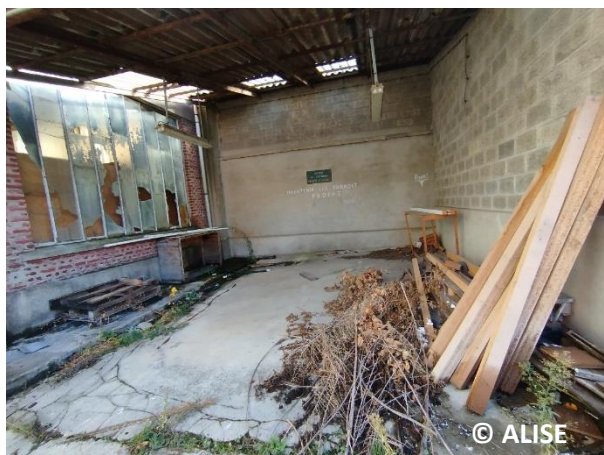
Photo 23 : Auvent, partie accolée aux garages et court de tennis. Peu favorable.
