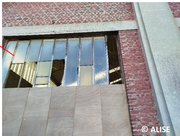
Photo 14 : Entrée possible par fenêtre cassée et grillage à maillage large (photo sur site)
