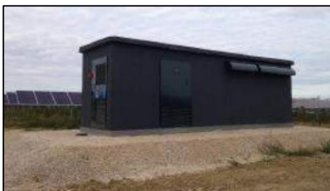
Figure 31 : Exemple de poste de transformation et de livraison
