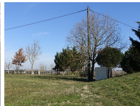
Ligne électrique BT Source : ARTIFEX 2023
