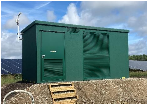
Figure 7 : Exemple de poste de livraison
