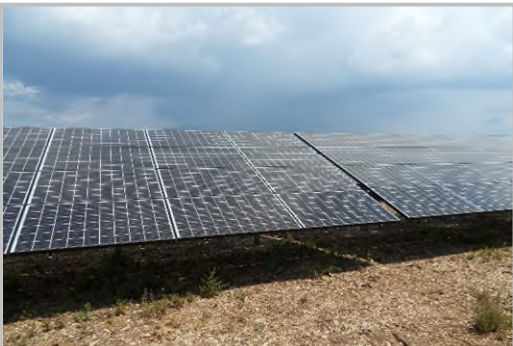
Photographie 13 : Vue des panneaux (Parc du Castellet déjà existant)
