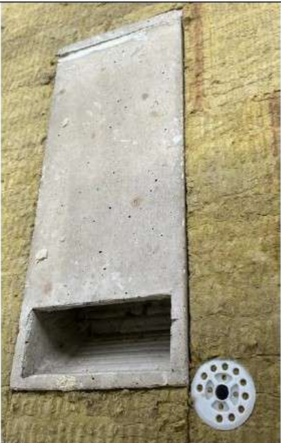
Figure 27 Photographie d'un gîte béton intégré dans l'isolation d'un bâtiment (source : Ligue pour la Protection des Oiseaux, Île de France)
