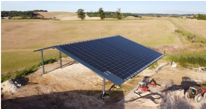
Photo 4 : Photovoltaïque sur hangar agricole
