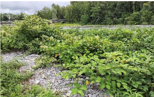
Renouée du Japon couvrant l'enrochement protégeant le dôme
