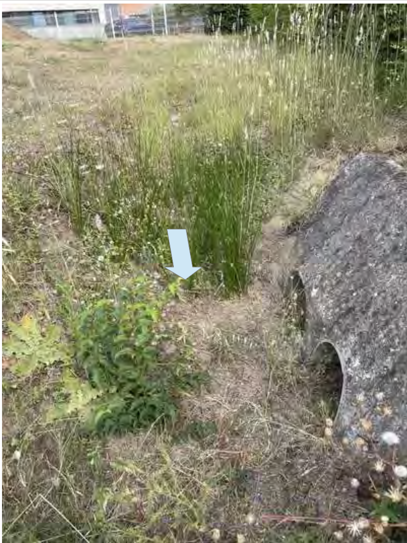
Photo N° 2 Vue de l'exutoire 1 du site (2xDN 400 mm)
