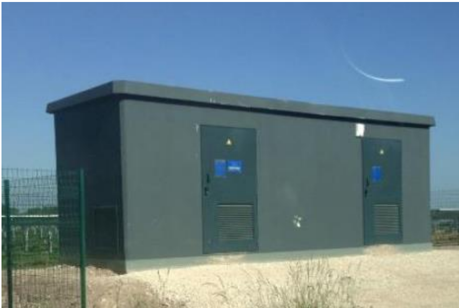
Photo 3 : Illustration de locaux techniques sur des centrales solaires au sol existantes (Source : TrinaSolar)
