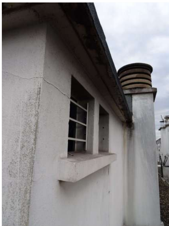
Édicule d'une cage d'ascenseur fermé seulement par une grille
