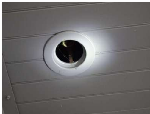
... ou encore à la faveur de luminaire manquant.
