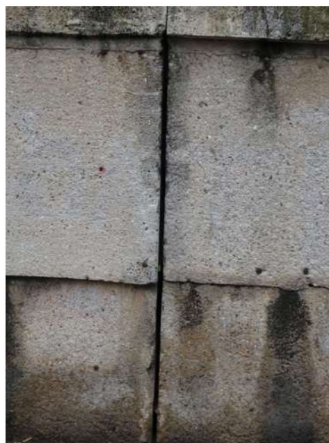
...présente des disjoints entre dalles de béton utilisables par la faune fissuricole, dont le Léopard des murailles.
