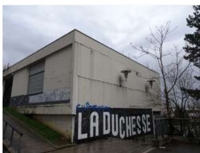
Le pignon sud ne présente aucun espace en façade ou au niveau de la couvertine d'acrotère.
