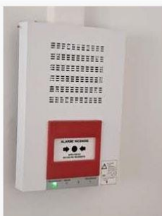
Alarme Incendie + boîtier
