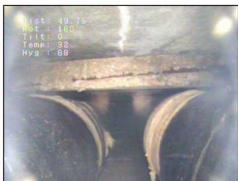
Exemple d'une dalle de caniveau affaissée
