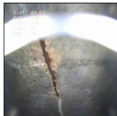
Exemple d'une dalle détériorée
