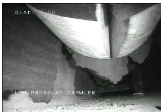
Exemple d'un calorifuge qui se dégrade
