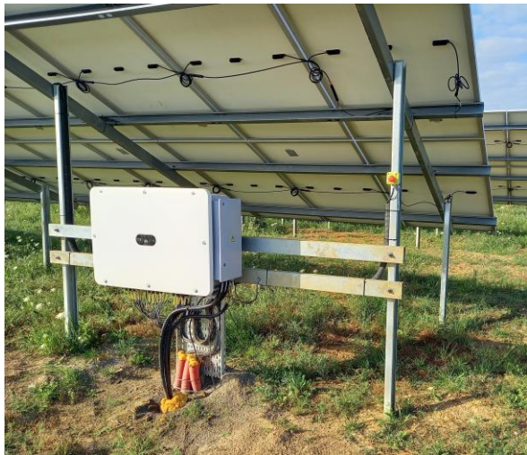
Figure 15 : photo d'un onduleur
