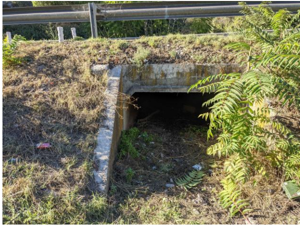
Buse sous route permettant le passage de chiroptères en sortie de vallon pour rejoindre le Paillon (Trini04)
