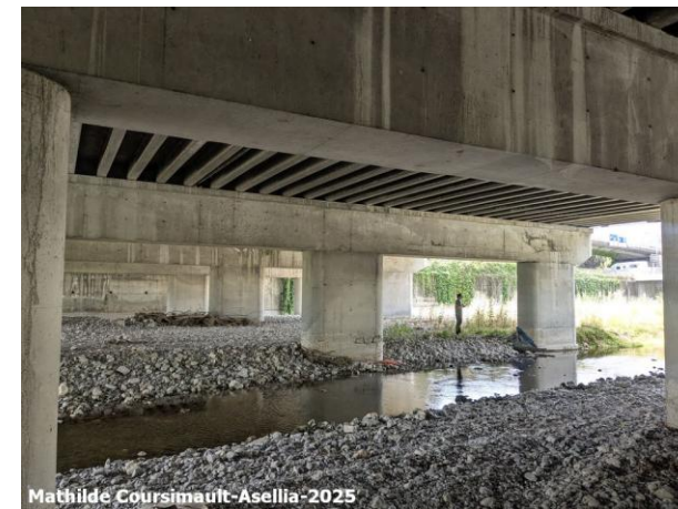
Pont Garigliano le Lion (enjeu Fort) abritant des gîtes utilisables (corniches et joints de dilatation)
