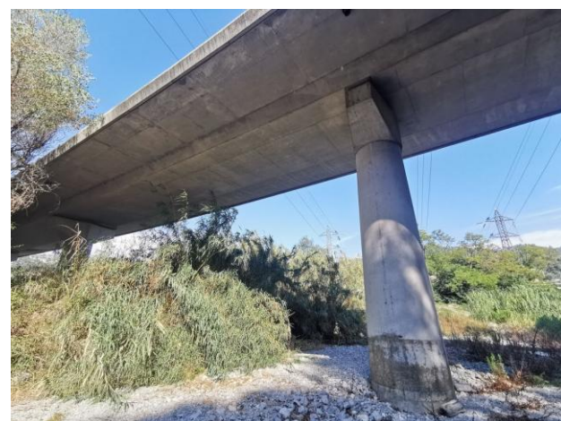
Pont secteur Sud de la Pénetrante (enjeu Très fort) qui abritait la colonie de Pipistrelles de Kuhl en 2022 et continue d'héberger des individus de Pipistrellus sp. en 2025
