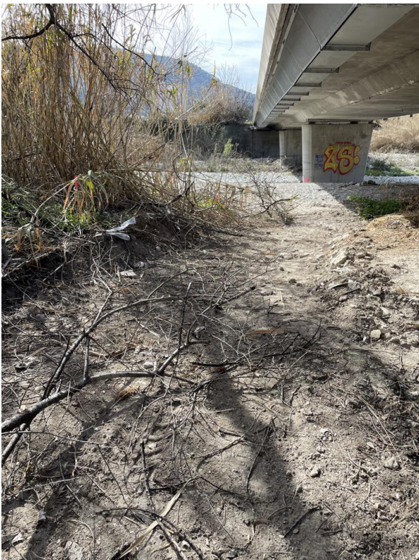
Incendie d'une voiture sous le pont de la pénétrante en février 2023
