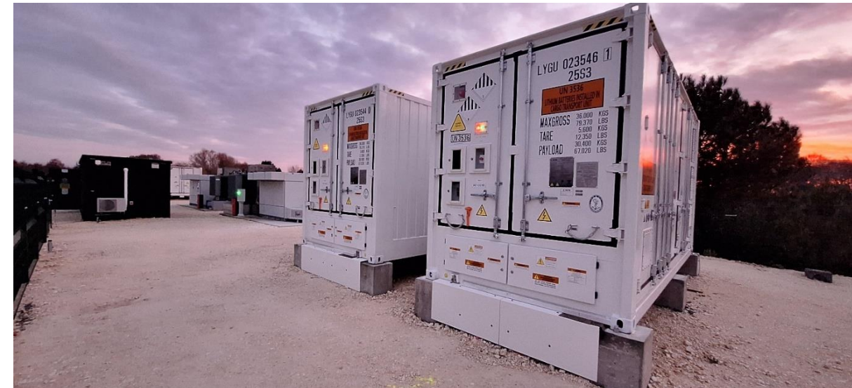
Exemple d'unité de stockage d'énergie (réalisation)
