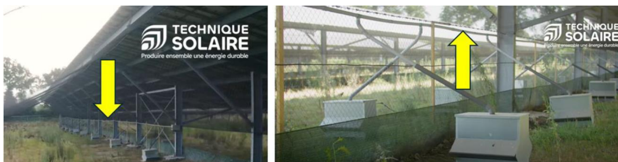
Figure 10 : Illustrations de la chaîne d'alimentation automatique intégrée sous ombrières
