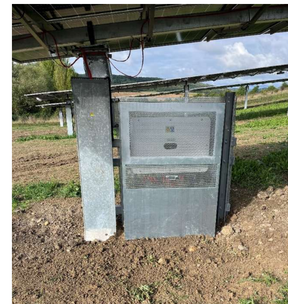
Figure 18: onduleurs string (source TSE)
