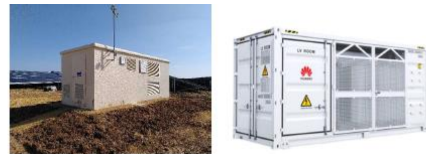
Figure 47 : Exemple de poste de transformation béton (à gauche) et métallique (à droite)
