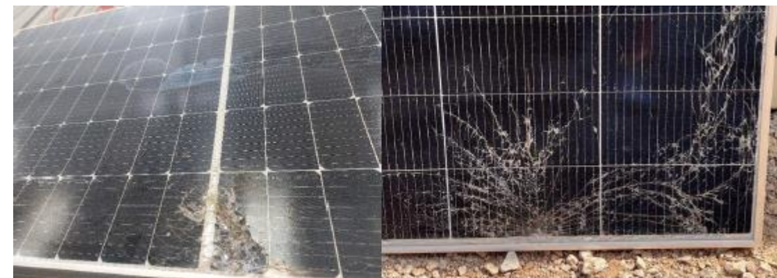
Figure 44 : Panneaux ayant subi un impact (source : TSE Energy)
