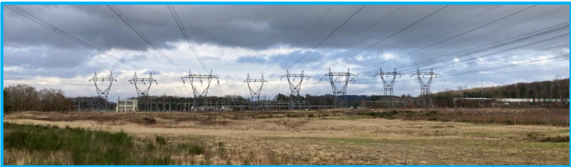
Figure 17 : Alignement de pylônes couvrant la largeur de l'entrée du poste électrique de SAINT-AVOLD
