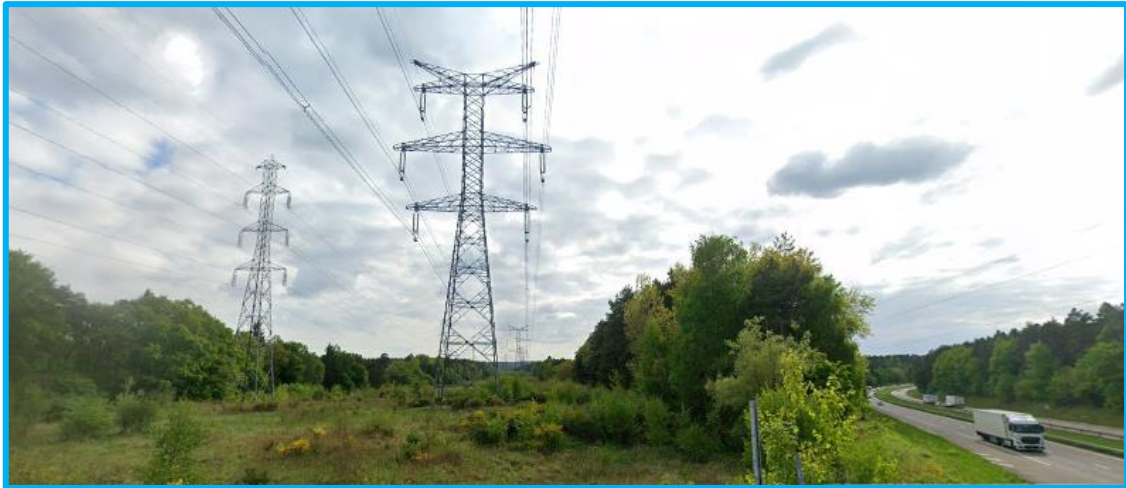
Figure 20 : Type de pylônes utilisés « en drapeau »
