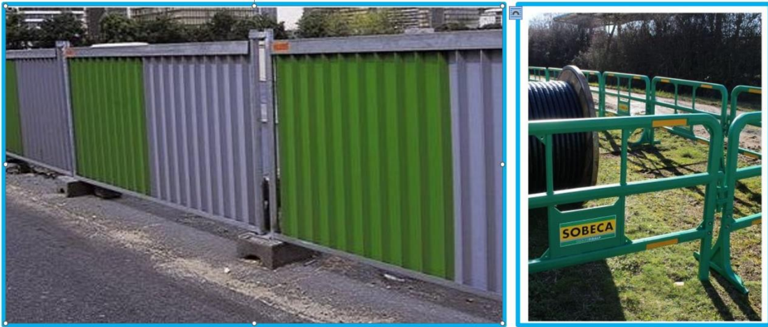
Figure 96 : Types de barrières pour la cloture du chantier
