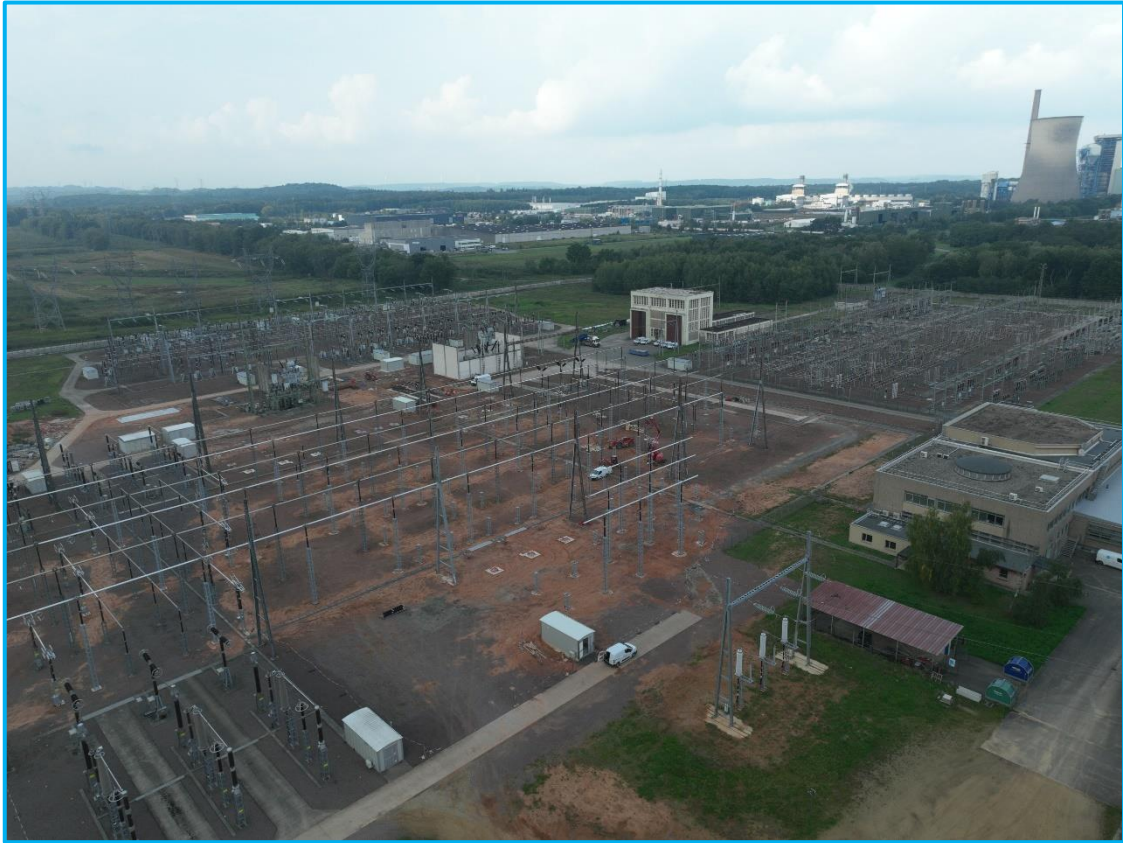
Figure 10 : Poste électrique de SAINT-AVOLD
