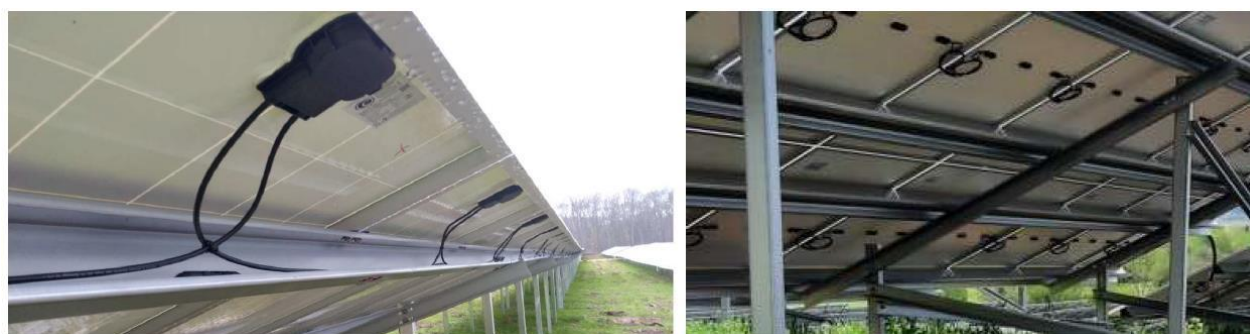
Figure 10 : Exemple de mise en œuvre du câblage DC sur structure porteuse Source : EES
