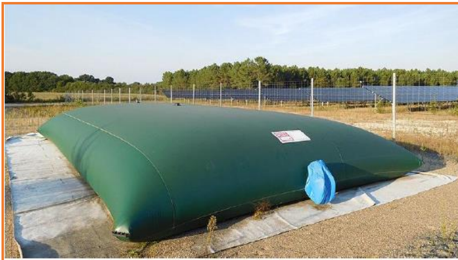
Figure 32 : Citerne incendie mise en place proche d'une installation photovoltaïque
