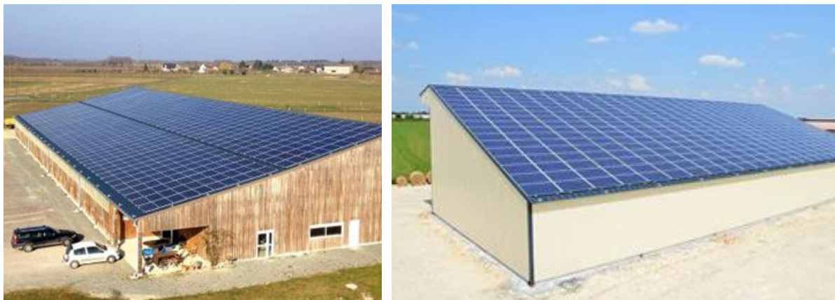
Figure 4 : Quelques références de toitures photovoltaïques du Groupe IEL (A gauche Azay-le-Rideau (37) – 229,32 kWc A droite St-Martin-de-Fraigneau (85) – 99,75 KW) (Source : IEL)
