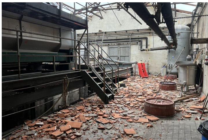
Figure 27 : Toiture de la cave après la tempête [Source : ©Thibaut Calatayud / Actu Perpignan]
