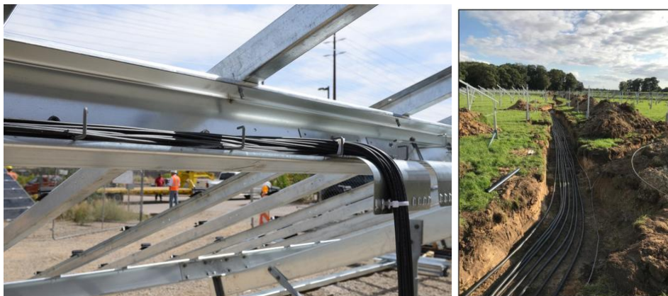
Chemin de câble aérien sur les structures & tranchée pour le câblage interne
