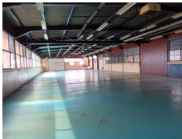
Hangar avec huiles sur le sol
