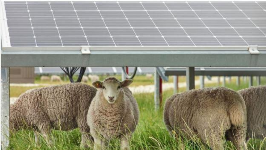
Figure 5 : Pâturage ovin sous des panneaux solaires (source : Unit-e)
