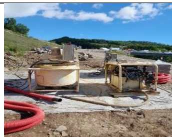
Exemple d'une installation de compresseurs sur tapis absorbant (Biotope, 2024)
