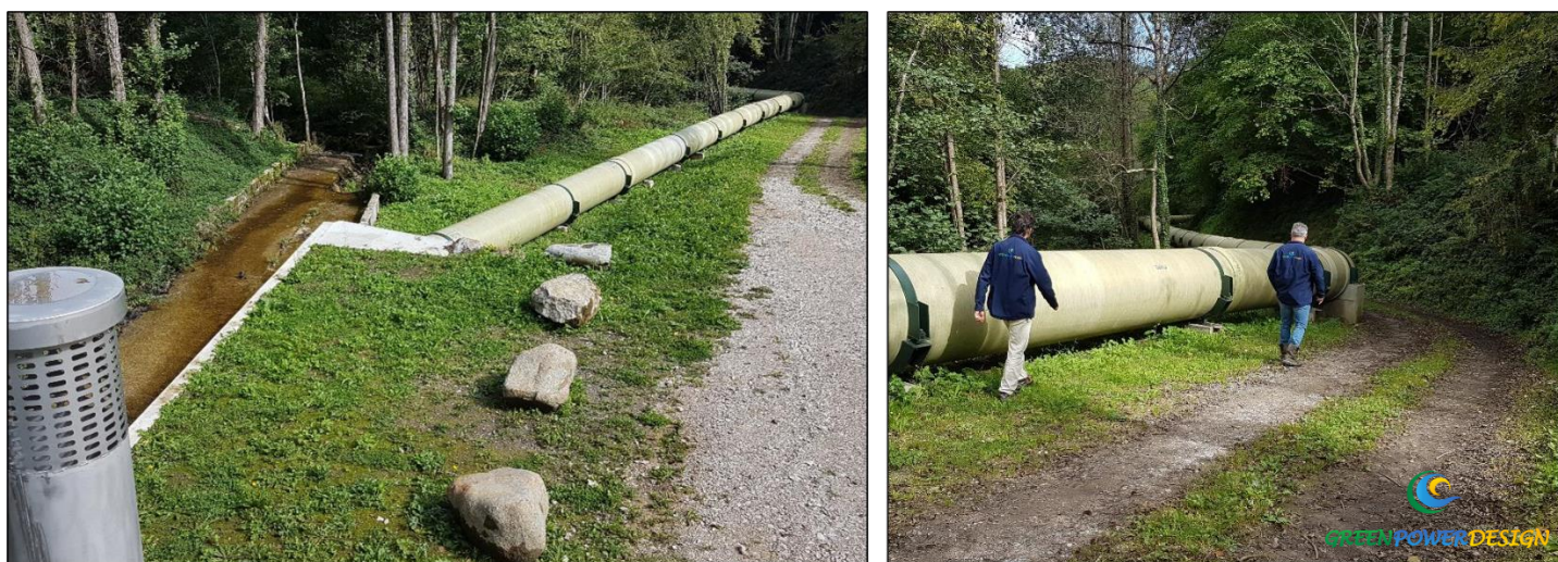
Figure 30 : Exemple de conduite forcée en PRV (Diamètre 1 200 mm)
