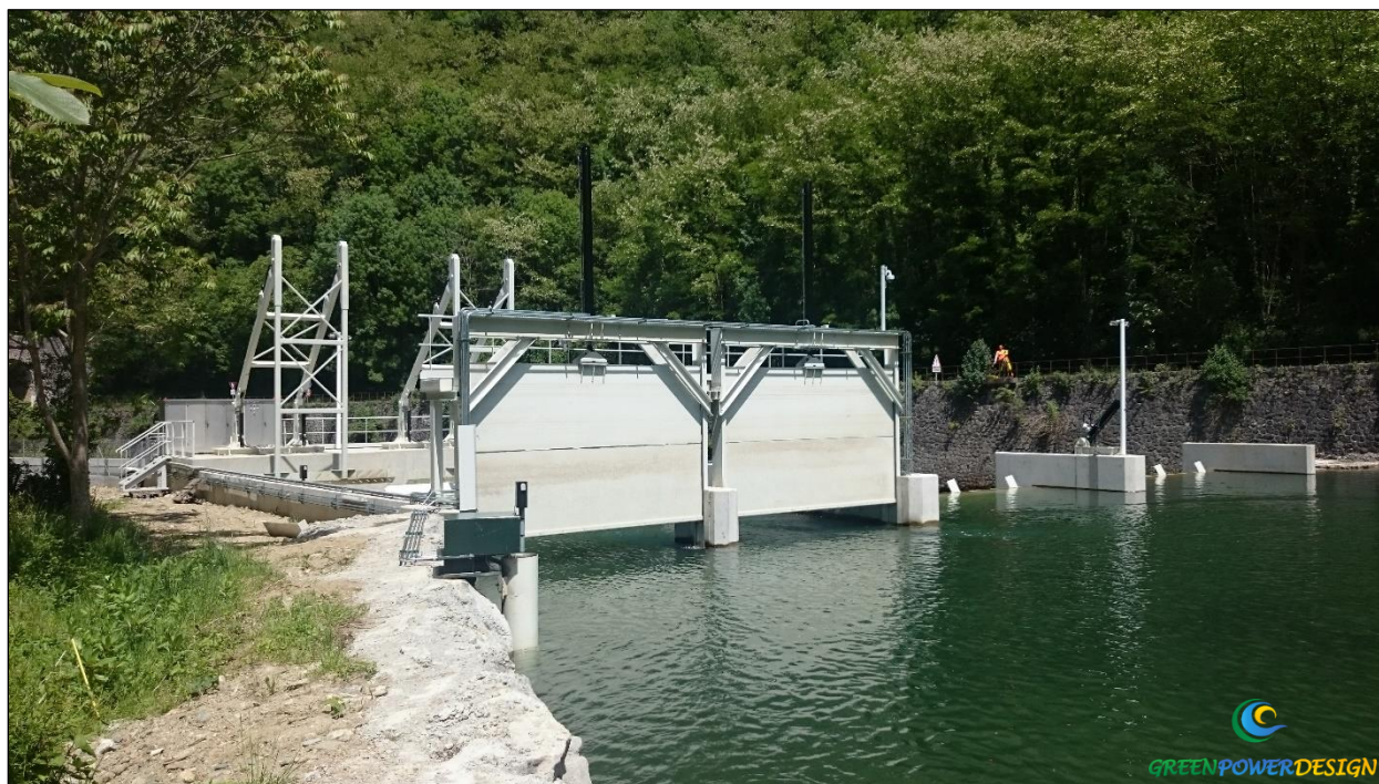
Figure 22 : Vannage de garde installé sur la rivière Salat (Etudes et MOE Green Power Design)
