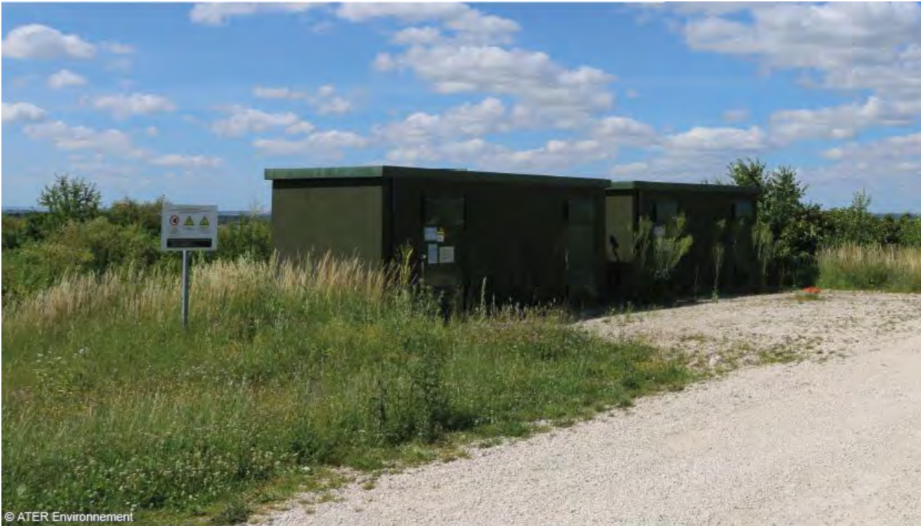
Figure 7 : Exemple de poste de livraison
