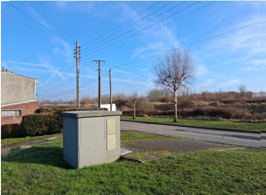
Image: Poste de transformation à proximité immédiat du site
