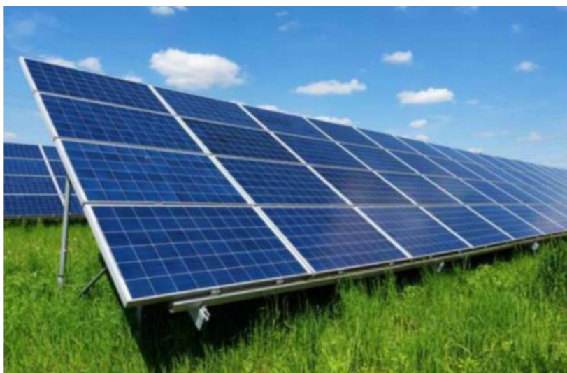
Figure 4 : Exemple d'installations photovoltaïques
