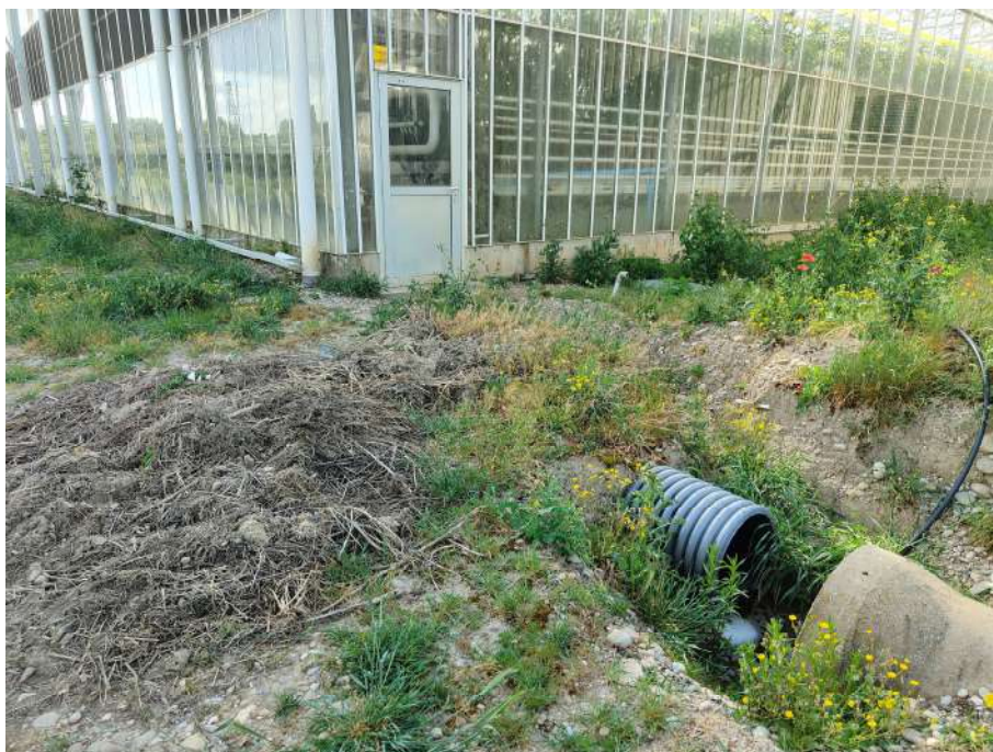
Ouvrage de collecte des eaux des serres existantes
