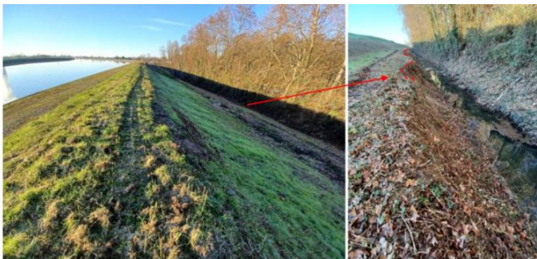
Figure 7 : Zone de glissement au niveau du talus RG du colateur en aval du pont des Fontaines
