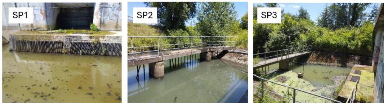
Figure 8 : Photos des stations de pompage (SP) n° 1, 2 et 3 concernées par le projet de curage
