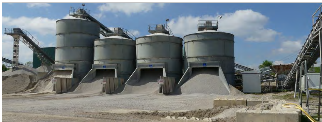
Photo des silos de stockage des matériaux de différentes granulométries sur le site des installations
