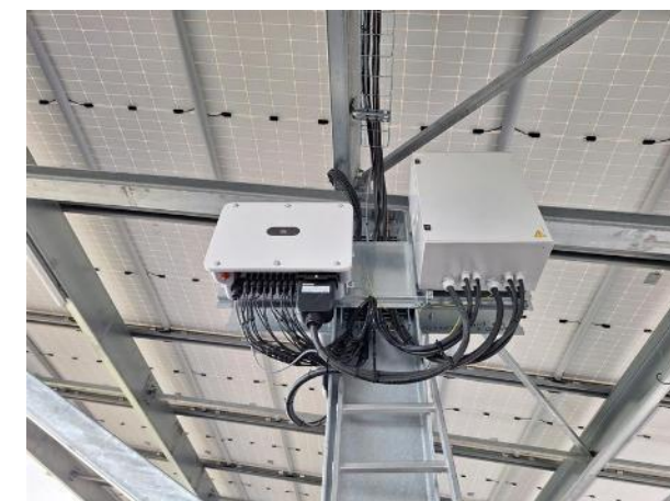
Figure 8 : Onduleur sur ombrières
