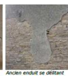
Ancien enduit se décollant
