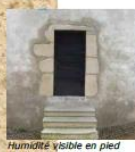
Humidité visible en pied de mur
