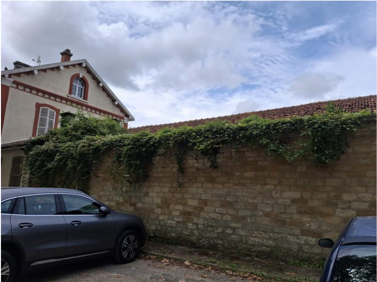
Photo 1 : végétation grimpante du bâtiment 1
