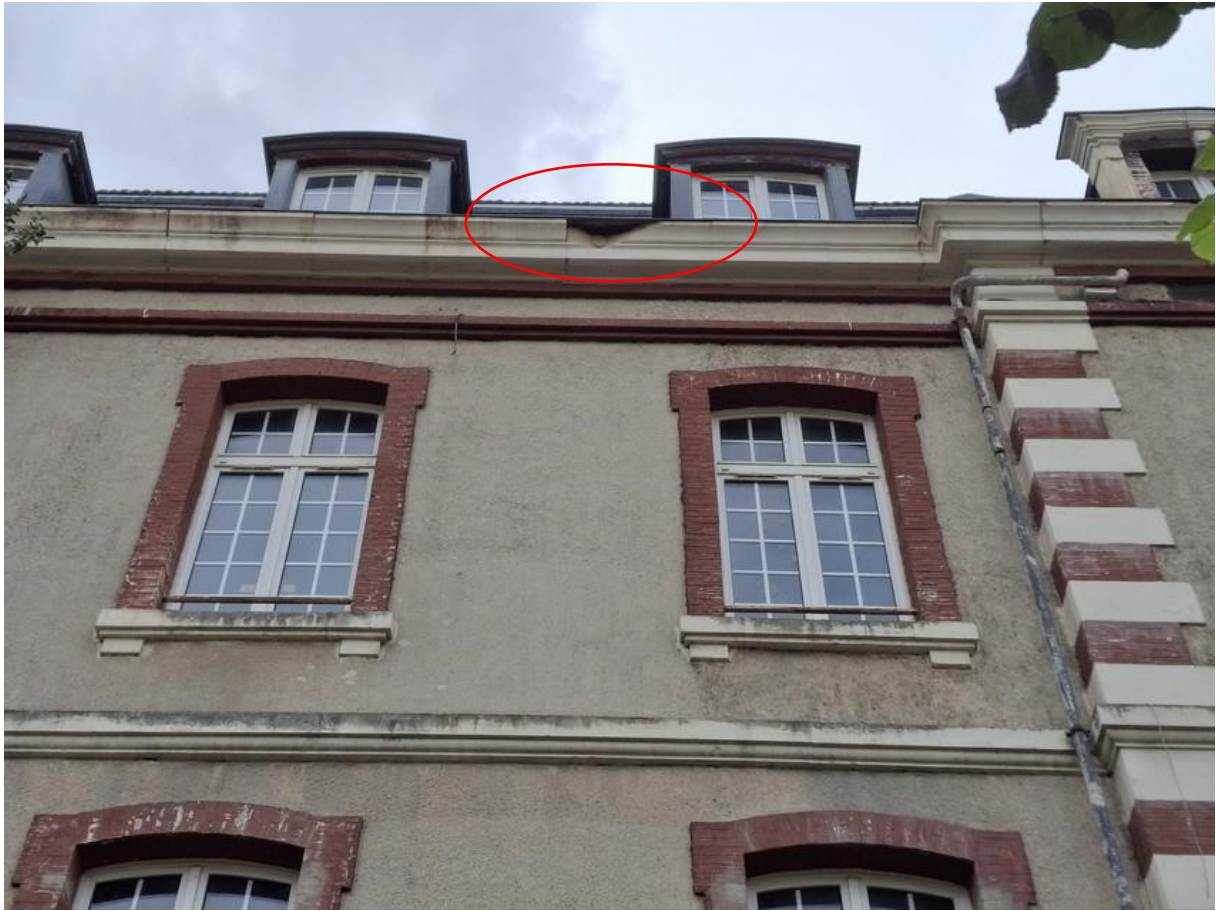
Photo 4 : cavité bien visible sur la corniche du bâtiment 0054
