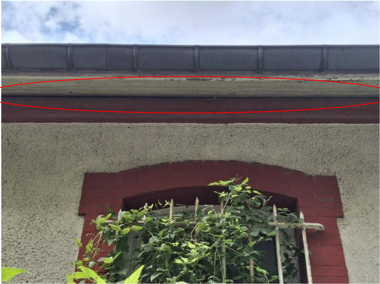
Photo 7 : interstice entre le bâti et la toiture sur le bâtiment 0074
