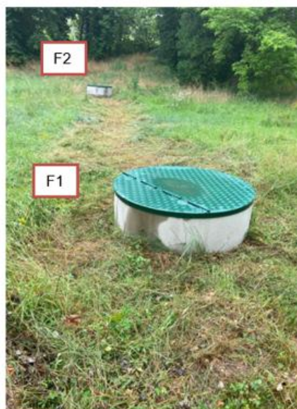
Figure 1 : têtes de puits F1 et F2 (source setec hydratec, juin 2023)
