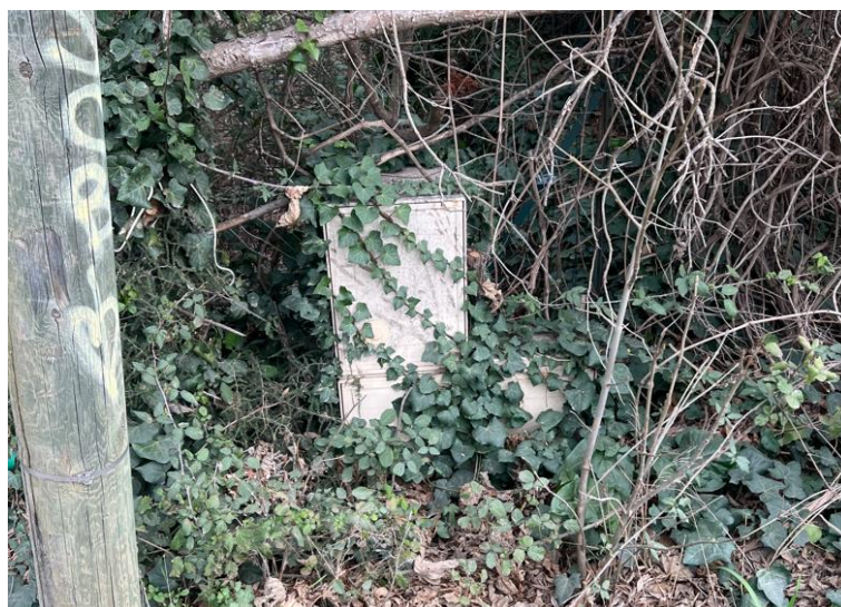
Figure 26 : Coffret électrique en aval rive gauche
