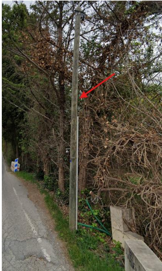
Figure 29 : Poteau électrique en aval rive gauche
